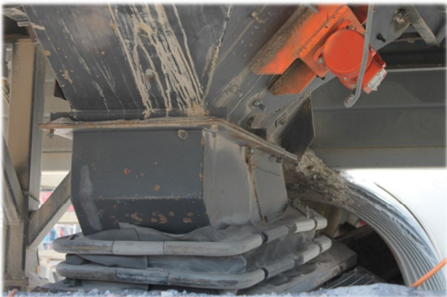
Kuva 15. Alitteen putoamiskohdan suojaus kuljettimelle.
